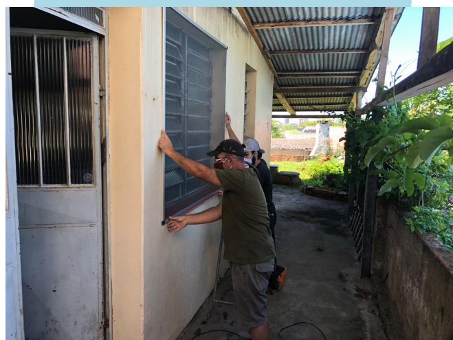
Telas nas janelas: segurança sanitária na Creche Santa Rita de Cássia.
